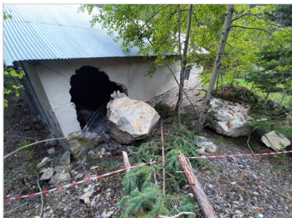
Chute de bloc sur le bâtiment du téléphérique de Terre Rouge au printemps 2020
